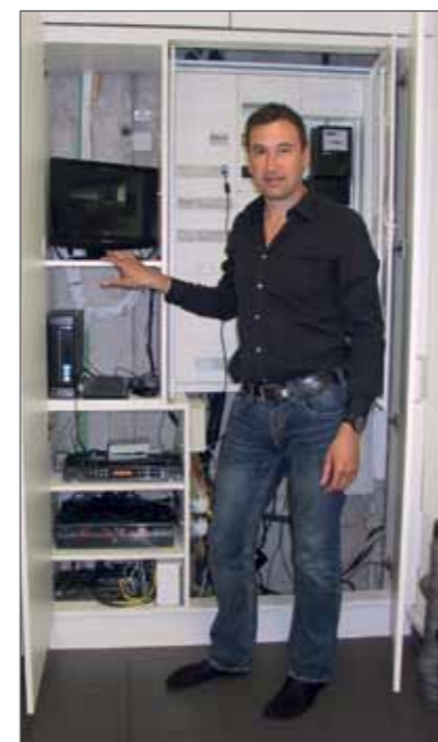
Zentraler Schaltschrank mit Medien- und FAP-Server
